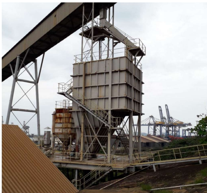
Figura 8: Silo do carregamento Rodoviário Fonte: EVTEA – Pier3 - 2018
