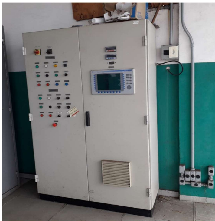
Figura 2: Painel de controle Fonte: EVTEA – Pier3 - 2018
