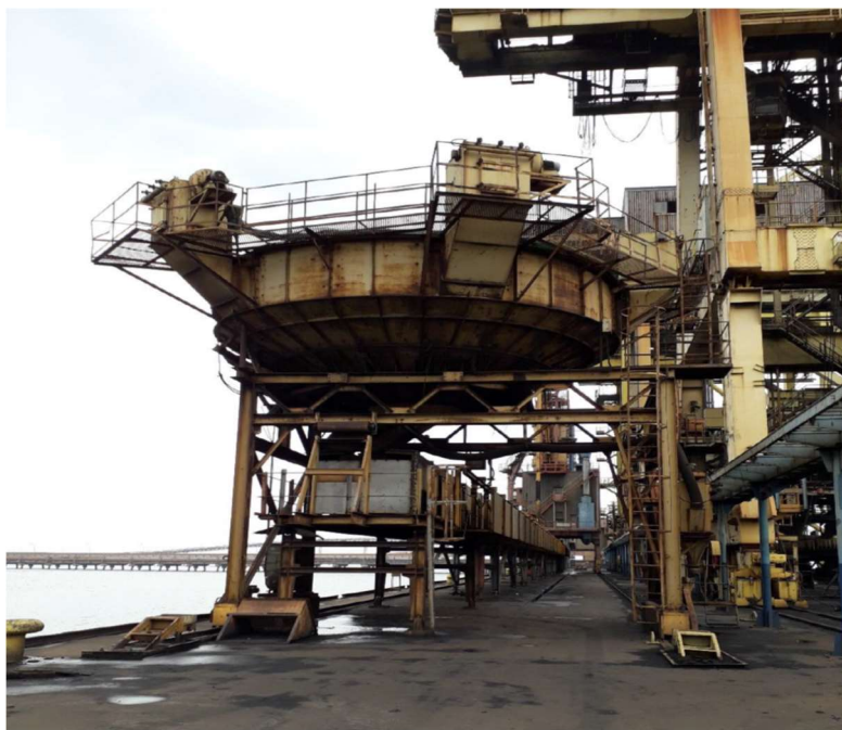
Figura 9: Moega Portuária para Barrilha. Fonte: EVTEA – Pier3 - 2018
